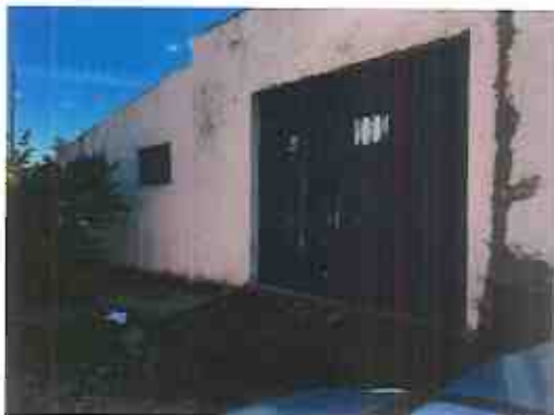
PORTÃO COM PINTURA DESGASTADA
