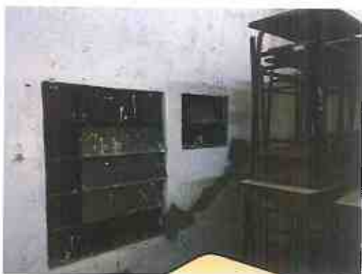
BASCULANTE COM VIDROS FALTANTES
