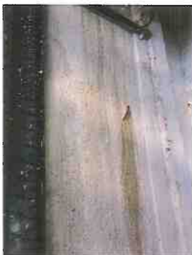
PINTURA TIPO CAIAÇÃO - EM CAL EM MAU ESTADO DE CONSERVAÇÃO
