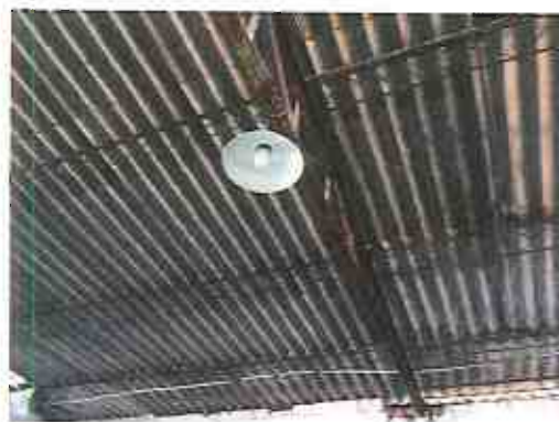
LUMINÁRIA ORIGINAL EM FUNCIONAMENTO
