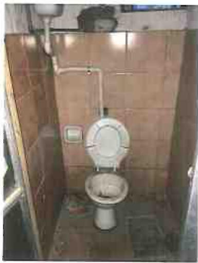
INSTALAÇÃO SANITÁRIA COM CAIXA SUPENSA E CANOS EXPOSTOS
