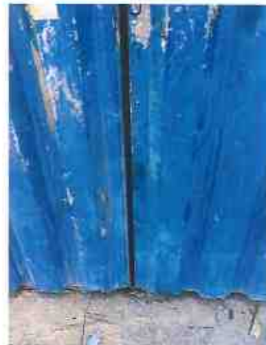
PORTÃO COM PINTURA DESGASTADA
