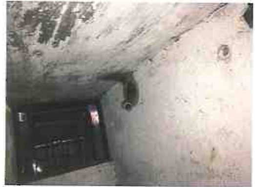
CAIXÃO DANIFICADA / INSTALAÇÃO ELÉTRICA DANIFICADA
