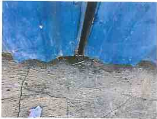
PORTÃO COM PINTURA DESGASTADA
